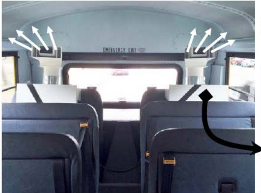
a. Jet Diffusers
